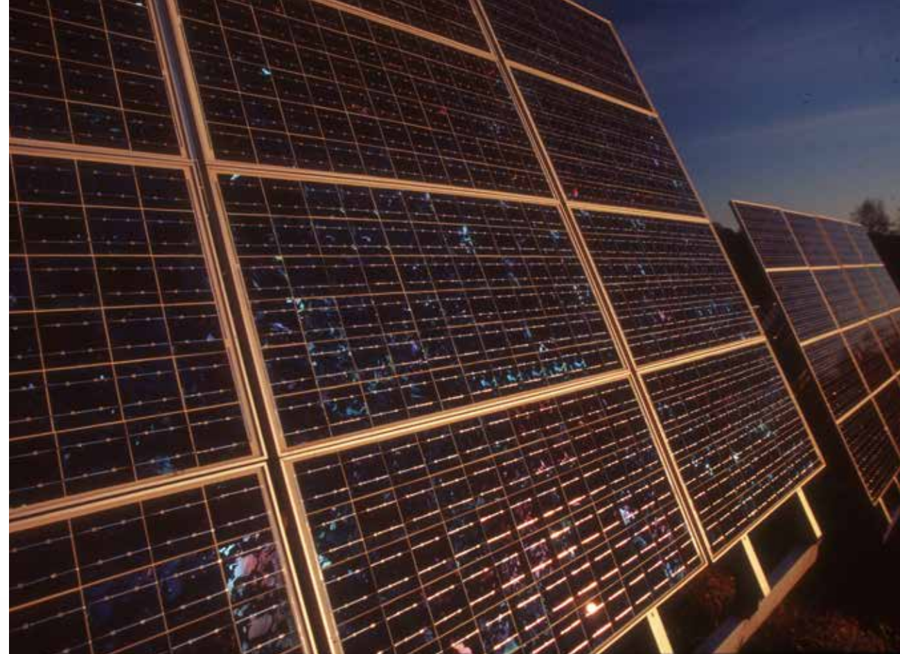
Figur 7. Energiparken på UiA slik den stod på Dømmesmoen. Den genfindes i dag ovenpå Mechatronics innovation lab, hvor forskellige solceller testes under forskellige klimaforhold. På rækværket til venstre ses en målestation, som måler udendørs klima og forurening.
